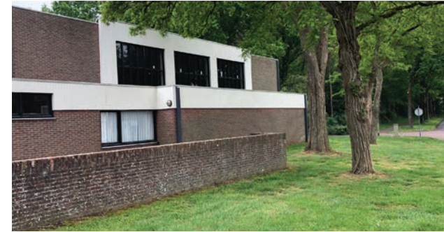
De Ludinge, Zuidlaren: doorlopend, eenlaags dakoppervlak en een hoger, plat dak van de gymzaal
